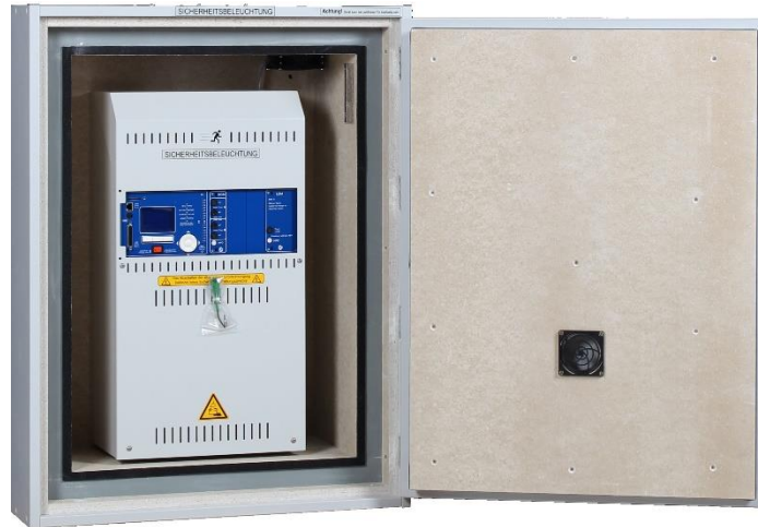
Abbildung 13: microControl plus im E30-Brandschutzverteilergehäuse
